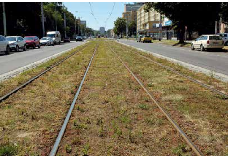
Nevyhovující stav vegetace tramvajové trati v důsledku nepříznivých klimatických podmínek, zejména velkého sucha
