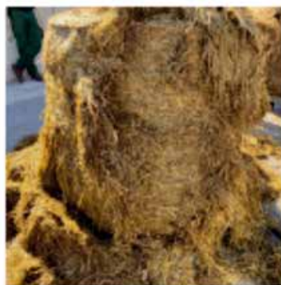
NEOŠETŘENÁ po odstranění poškozených částí
