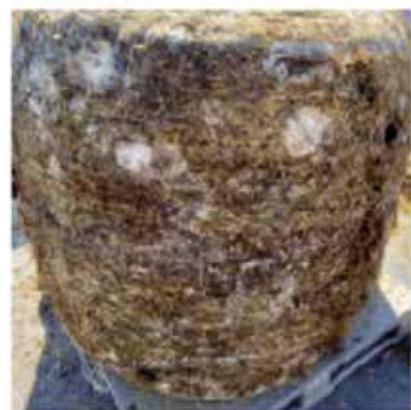
NEOŠETŘENÁ před odstraněním poškozených částí
